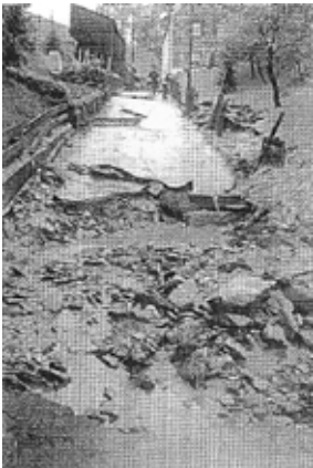
Die Straße zu und vor Nr. 10 hatte es total weggerissen.
