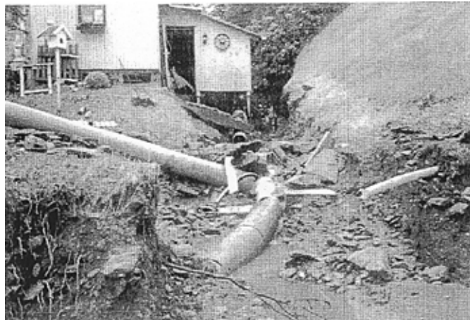
Sturzflutschäden am Anwesen Mondon, Nr. 15
