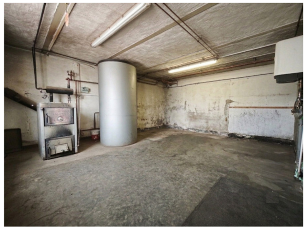
Heizung – Anbau KG
